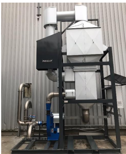
Lebensmittel- & Getränkeindustrie - Treibgasabfüllung Leistung: bis 1.600 Nm 3 /h
